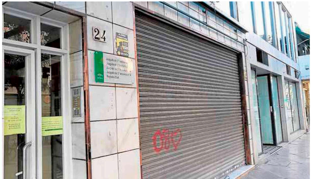
El edificio afectado, en el número 24 de la avenida Palma de Mallorca, es la sede más antigua. :: A. G.
